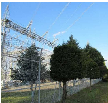
①変電所 (朝日村)
