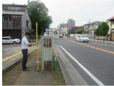
②路上変圧器 (国道1号、大磯町役場周辺)
