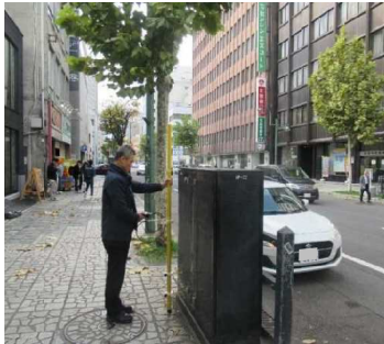
①路上変圧器 (大通駅周辺)
