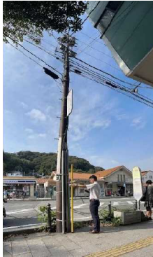
①配電線、ケーブル立上り (大磯駅前付近)
