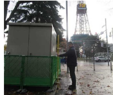
④変電設備 (大通公園)
