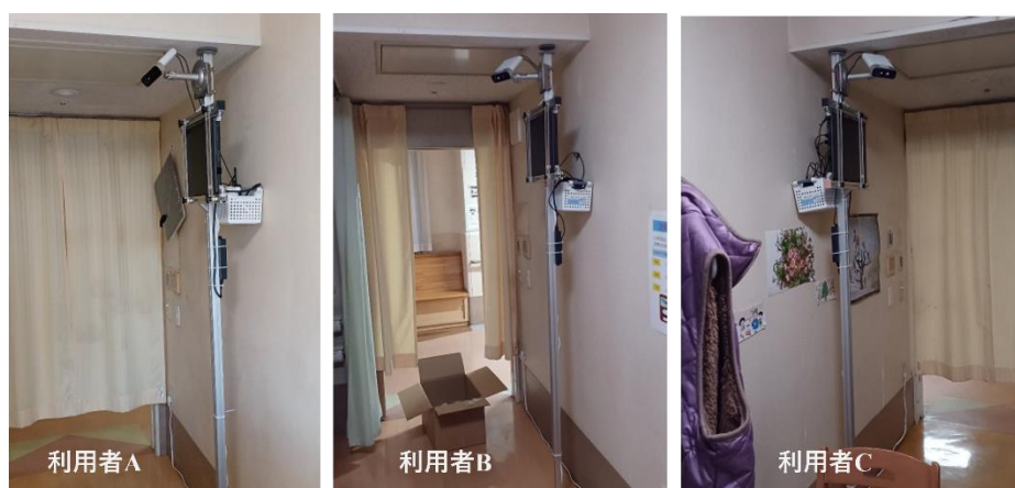
図 56 モニタリング用カメラの設置例
