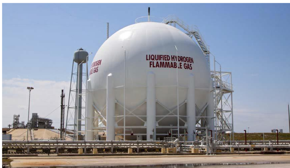
図 3.2- 1 米国ケネディ宇宙センターに最近新設された液化水素貯槽
