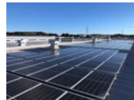
太陽光パネル施設（千葉北総）
