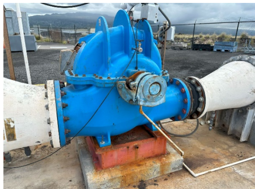
ポンプ モーター部
