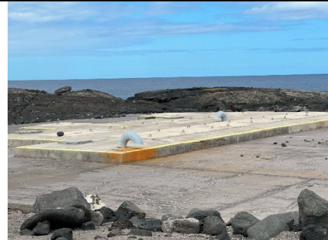
40"ポンプステーション
