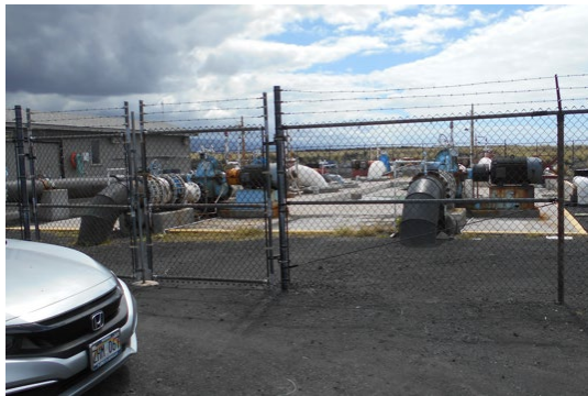
55"ポンプステーション
