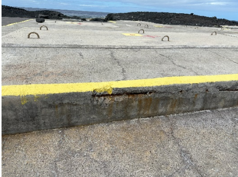
40"ピットカバー 鉄筋が腐食している
