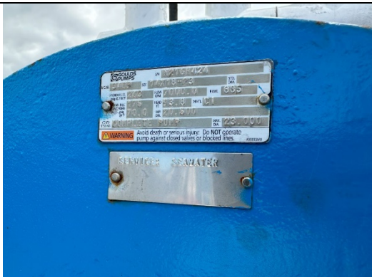
ポンプラベル (GOULDS PUMPS 社)
