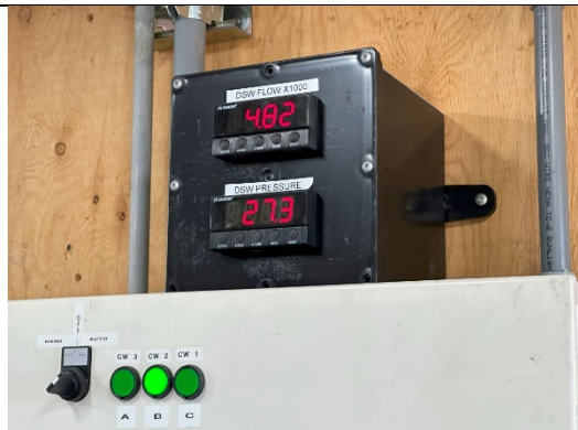
深層水配水管 流速・圧力モニター
