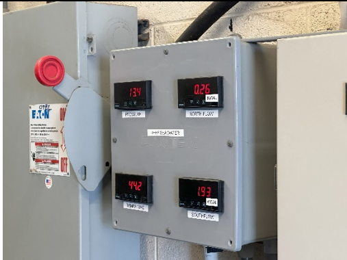
北ポンプステーション 圧力モニター
