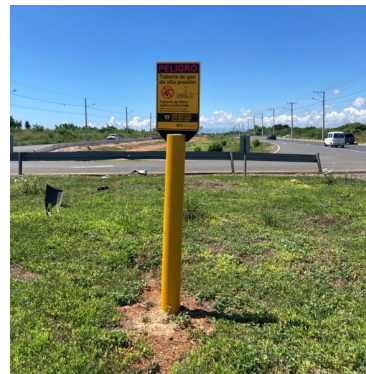
ガス管の標識
