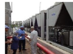
印刷工場のヒートポンプ
