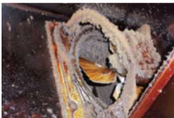
汚れた換気扇
