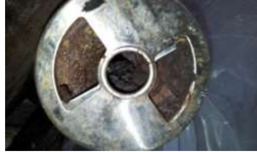
給気口の腐食
