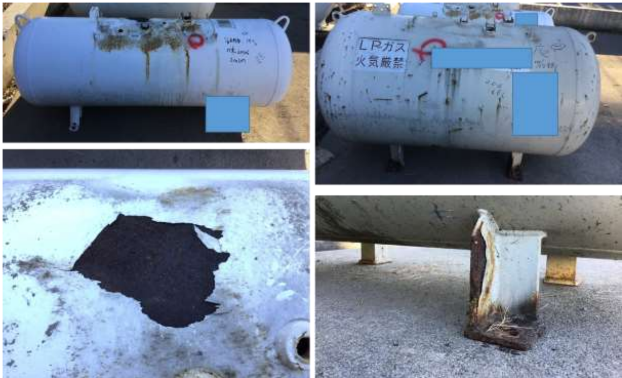
図5 告示検査の外観検査で破棄を決定したバルク貯槽
