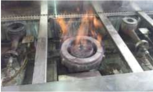
劣化による不完全燃焼
