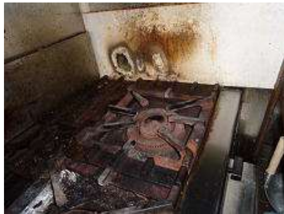
レンジ周りの油に引火した跡
