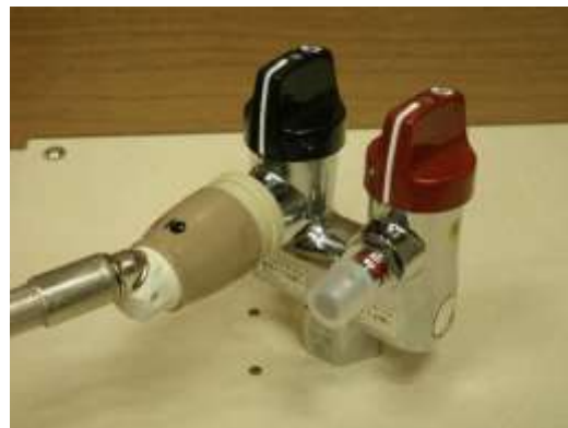
保護キャップを装着したガス栓
