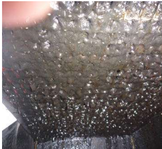
汚れた屋外排気出口
