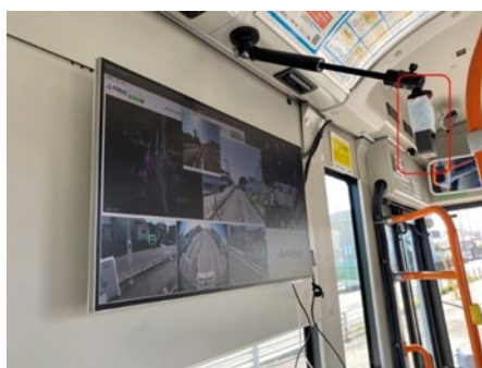
図 2.2-10 制御モニタ撮影用カメラと設置場所
