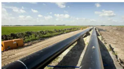
図 2.1 オランダで建設が進む水素パイプライン
