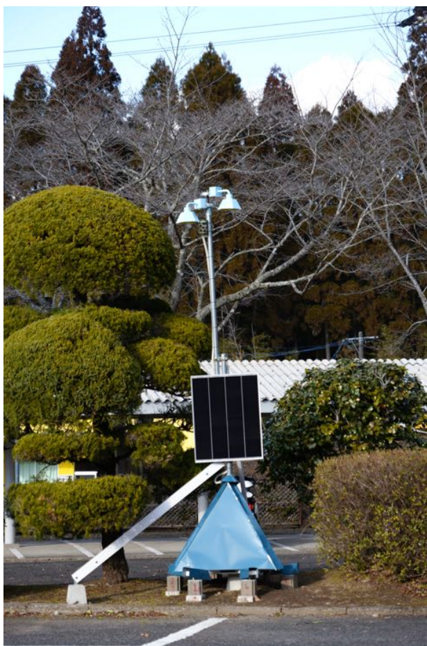
図 2-14 太陽光発電による自立型電源システム防犯灯全景
