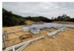
▲資材の放置等、ずさんな施工状態の様子
