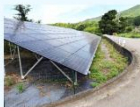
▲柵等の途切れている設備
