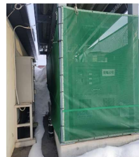
導入した非常用自家発電機
