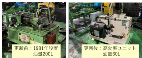
<油圧ユニット高効率化更新>
