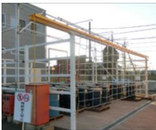
津波や河川氾濫で屋外にあるドラムの流出防止対策。
