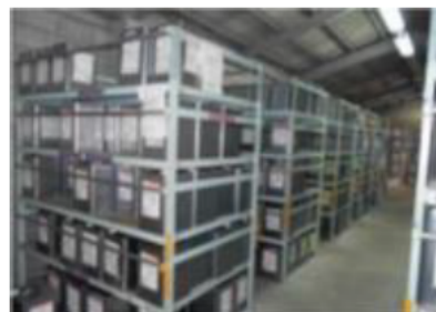
【石油缶ラックの落下防止柵】
