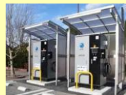
充電スタンド・蓄電池
