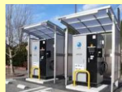
充電スタンド・蓄電池
