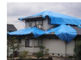
▲屋根用応急シートの施工例 （左：萩原工業株式会社より提供、 右：一般社団法人プロボノ消防志より提供）
