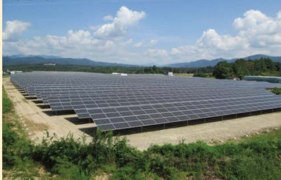
<庄原太陽光発電所>
