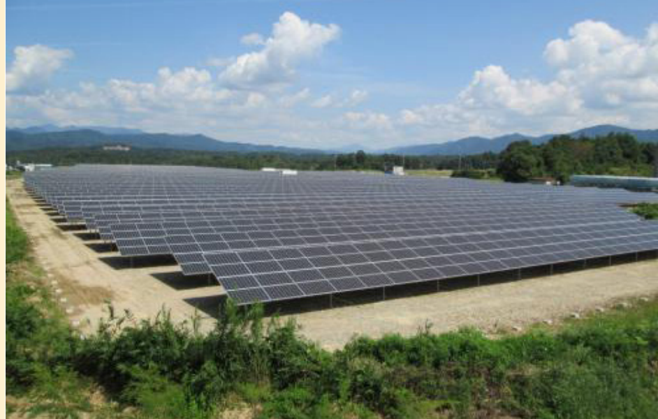
<庄原太陽光発電所>
