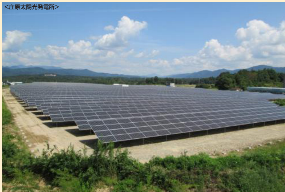
<庄原太陽光発電所>
