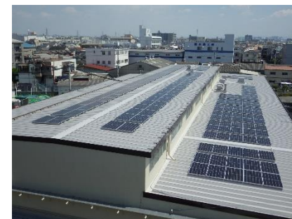
太陽光発電設備導入例 (既存工場棟屋根に既設の 太陽光パネル)
