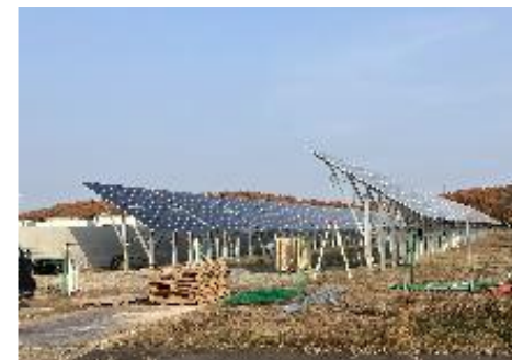
太陽光発電システム導入 苫小牧本社
