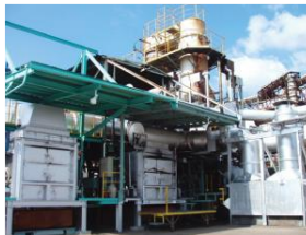
電池の無害化 処理工程
