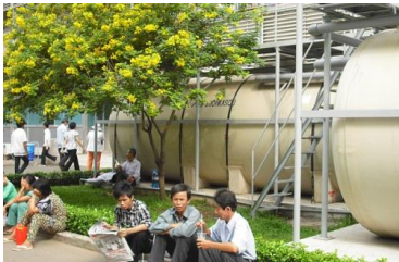
▲病院に設置された浄化槽
