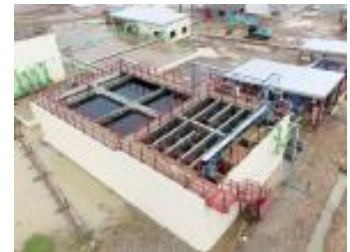
▲ティラワ工業団地ゾーンAに施工した浄水場
