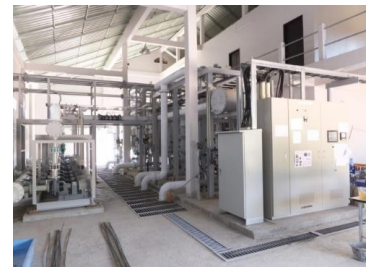
▲高濁度原水対応型浄水装置
