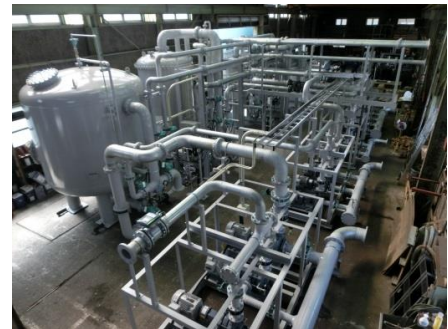
▲高濁度原水対応型浄水装置
