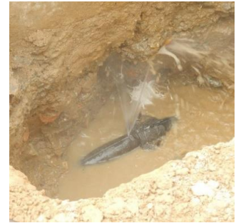
▲特定された漏水箇所
