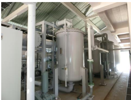
▲高濁度原水対応型浄水装置
