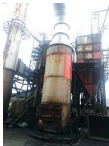
改善後の湿式集塵装置
