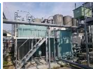
改善後の排水処理装置
