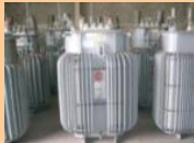
高圧トランス
