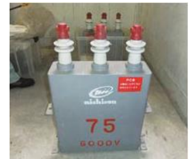
電力用コンデンサー
