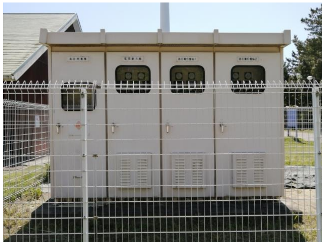
写真1 キュービクル
