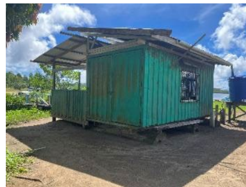
スアバナオ空港のターミナルビル
