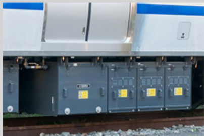
非常走行用バッテリー
