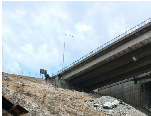
橋台部の補強は行われていない様に見える
