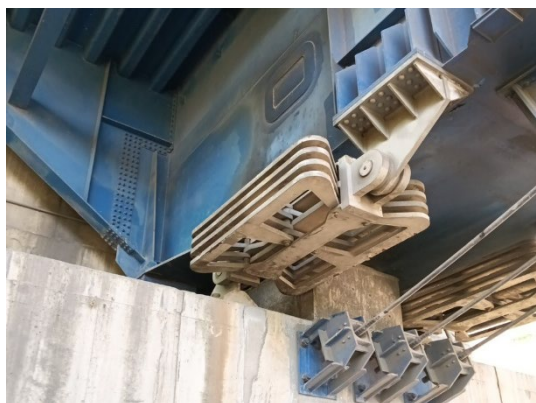
制震ダンパーと落橋防止ケーブル
