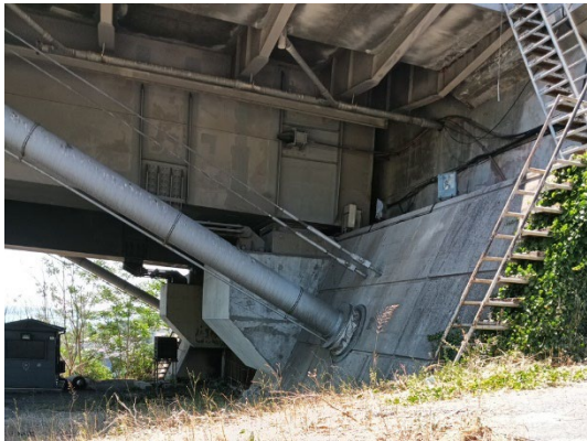
制震ダンパー（梁下部）と落橋防止ケーブル
