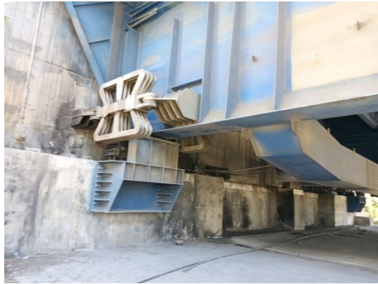
制震ダンパーと落橋防止ワイヤー、追加の梁
