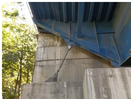
浮き上がり防止装置
