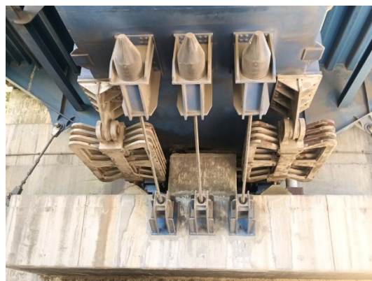
制震ダンパーと落橋防止ケーブル
