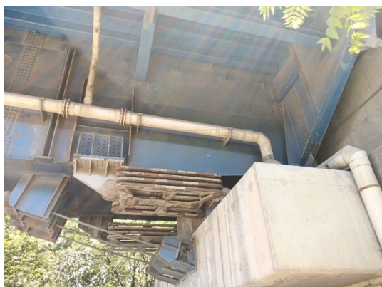
制震ダンパーと落橋防止ケーブル
