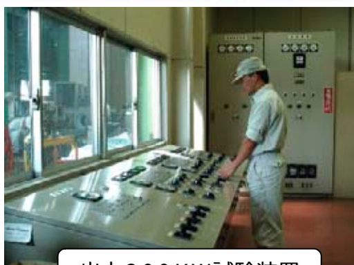
出力300KW試験装置
