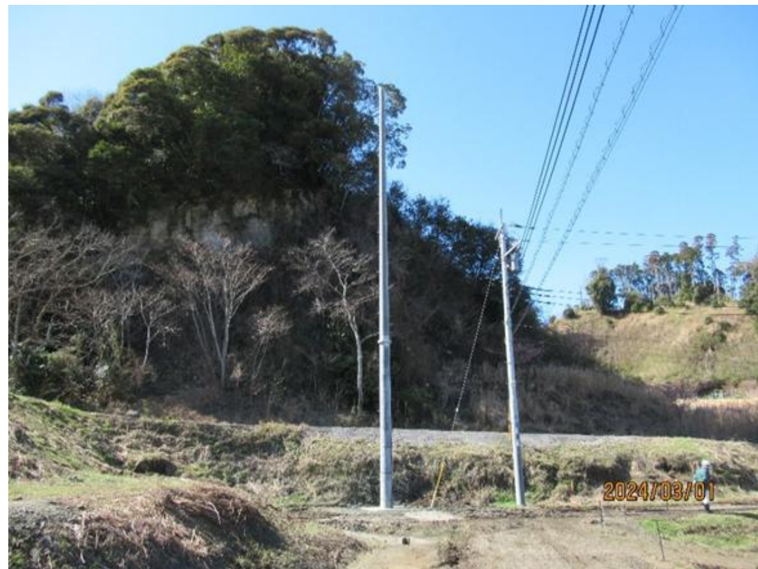
地上デジタル放送共聴設備
