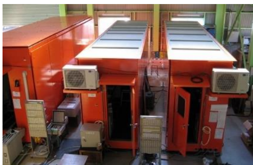
ゴライアスクレーン用電気室
