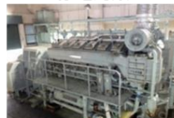
例：自家発電機の整備
