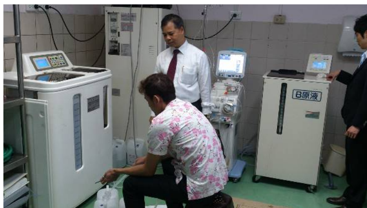
図・表 44 供給装置、A 剤溶解装置、B 剤溶解装置、透析用監視装置の設置状況
