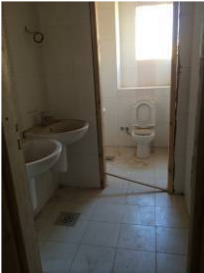
1F WC 湿式(床に水を流す)仕様 日本では乾式が主流
