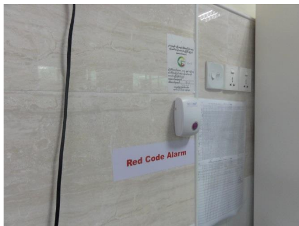
図表・59 Red Code Alarm 設置
