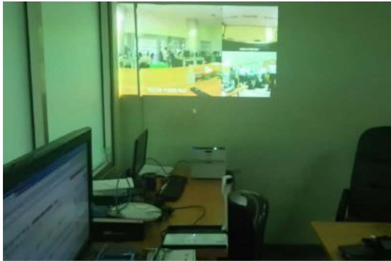
図表 13 Web/TV 会議システムの現場設置
