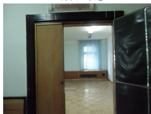
CT 設置室扉鉛シールド
