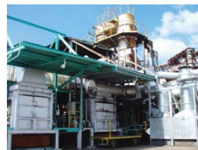
電池の無害化 処理工程
