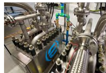
水素製造装置
