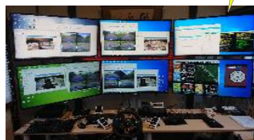
遠隔監視・操作室
