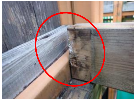
剥がした床板端面付近の腐朽菌菌糸
