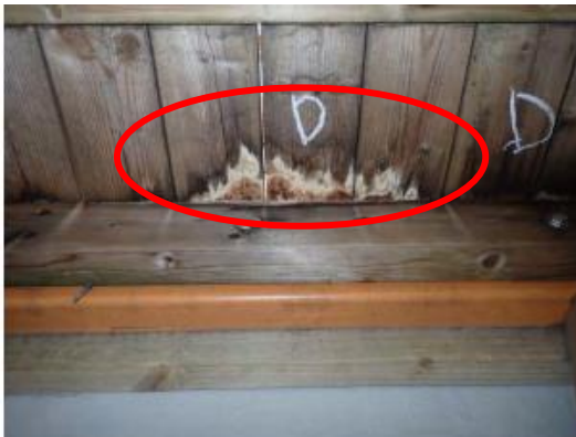
床受け木と床板の腐朽
