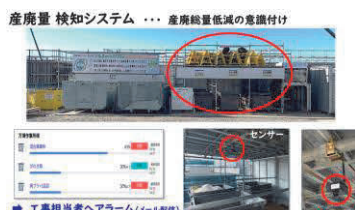
〈産廃量検知システム〉
