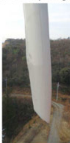
ブレードの損傷
