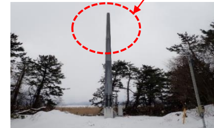
<風車の羽根の脱落>
