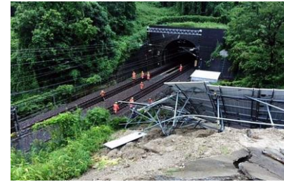
<太陽光パネルの崩落>
