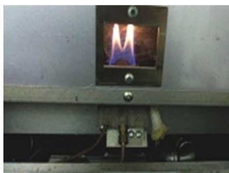
劣化したパイロットバーナーの炎
