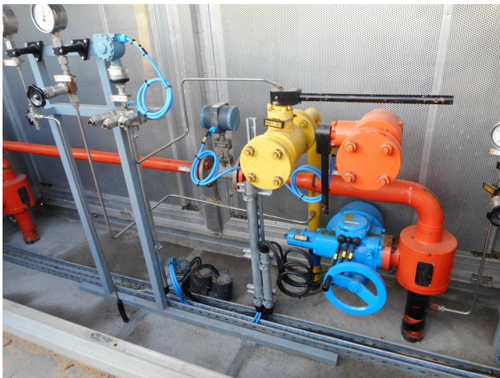
図 1. 4. 7 バルブステーション
