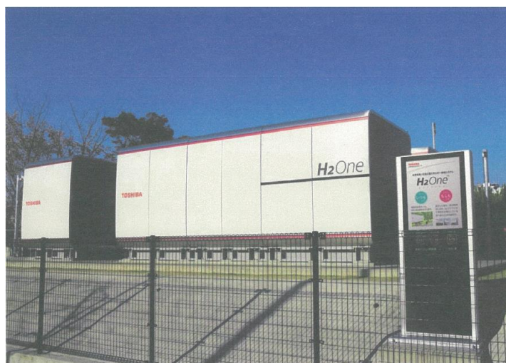
図 1. 3. 3 東扇島川崎マリエン H2One 設置状況
